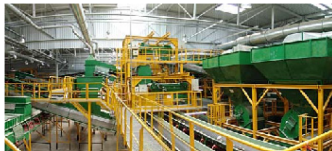
Siebtrommeln in der mechanischen Vorbehandlung der MBA Cröbern
